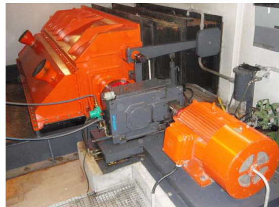
Turbine hinten / Asynchronmaschine als Generator vorne
