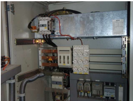
Einspeisung mit 400 V Drehstrom
