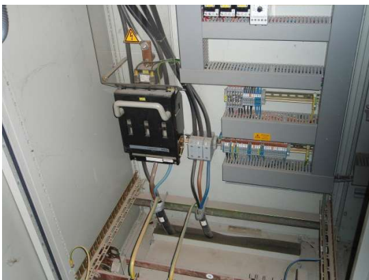
Absicherung über Niederspannungs Hochlastsicherungen
